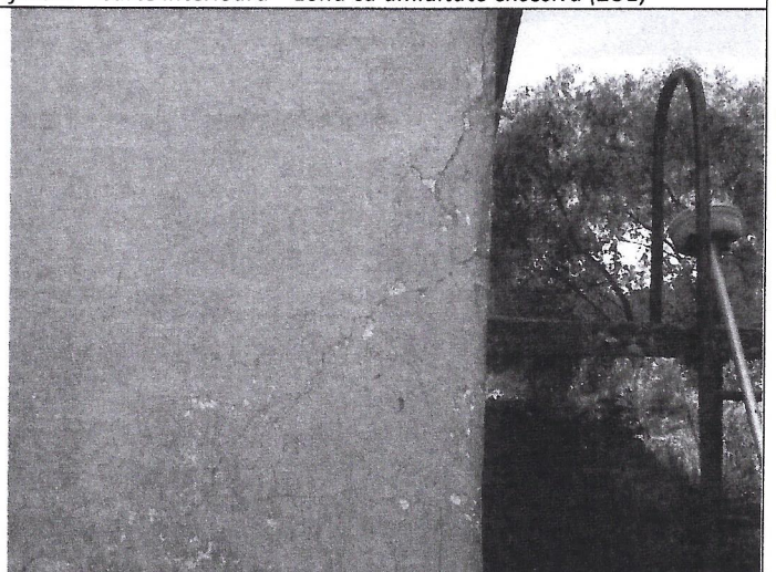
foto 4 – Colț clădire fisurat, degradat
